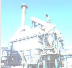
木質バイオマスプラントの 設備仕様評価・環境アセス
